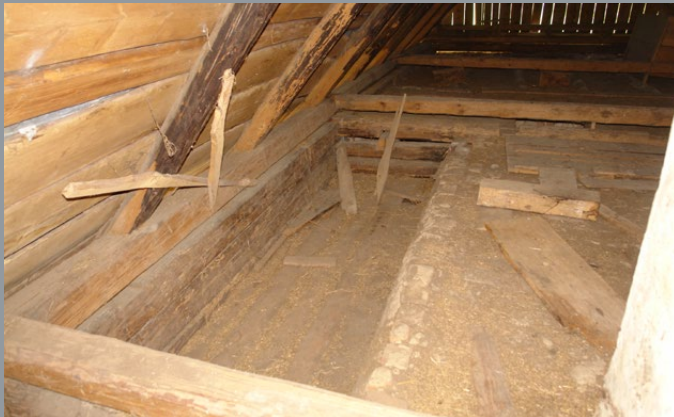
Il. 29. Poddasze Pigińcówki – obniżony strop nad alkierzem (po lewej) i wysoko zawieszony pułap izby (po prawej). Strop nad izbą pokryty jest glinianą polepą – reliktem półkurności chałupy. Ślady długotrwałego oddziaływania dymu widoczne są na wszystkich starych belkach, za wyjątkiem nowej płatwi i wzmacniających je łączników, fot. T. Łopatkiewicz, maj 2020
