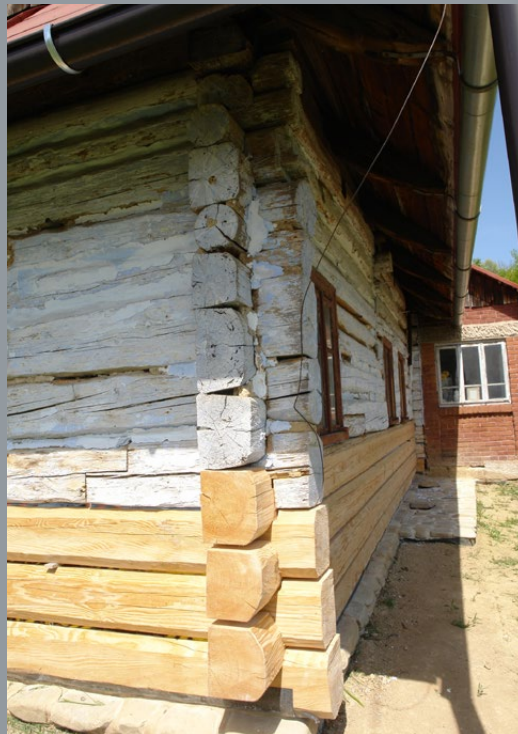
Il. 3. Węglowany na obłap narożnik południowy chałupy. Trzy dolne wieńce bełek wymienione w toku niedawnych prac remontowych, fot. T. Łopatkiewicz, maj 2020
