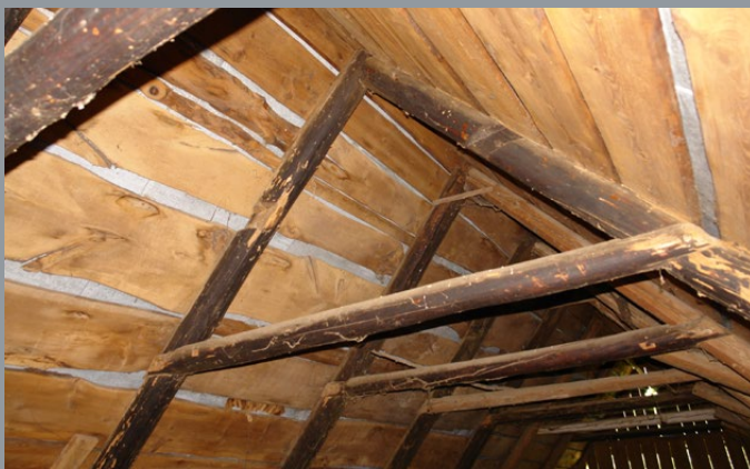
Il. 30. Para starych krokwii pochodzących z pierwotnego dachu czterospadowego i dwa gniazda powyżej jętki, w których osadzona była belka stabilizująca w pionie komin sztagowy, fot. T. Łopatkiewicz, maj 2020
