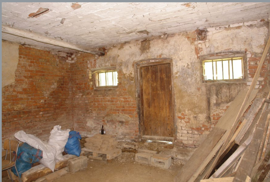
Il. 21. Wnętrze obory z widokiem na ścianę szczytową domu, fot. T. Łopatkiewicz, maj 2020
