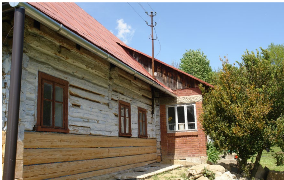
Il. 32. Załamana i podniesiona połać dachowa nad komorą i gankiem, fot. T. Łopatkiewicz, maj 2020
