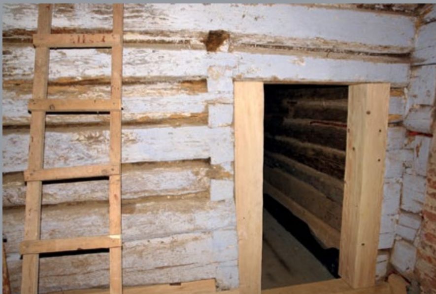
Il. 17. Odrzwia prowadzące do alkierza oraz węgłowanie belek ścian na rybi ogon – przy lewym węgarze i obłap – przy prawym, fot. T. Łopatkiewicz, maj 2020
