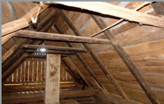
Il. 28. Południowo-wschodnia część poddasza Pigoniówki, ze starymi krokiewiami z czasów półkurności chałupy, fot. T. Łopatkiewicz, maj 2020
