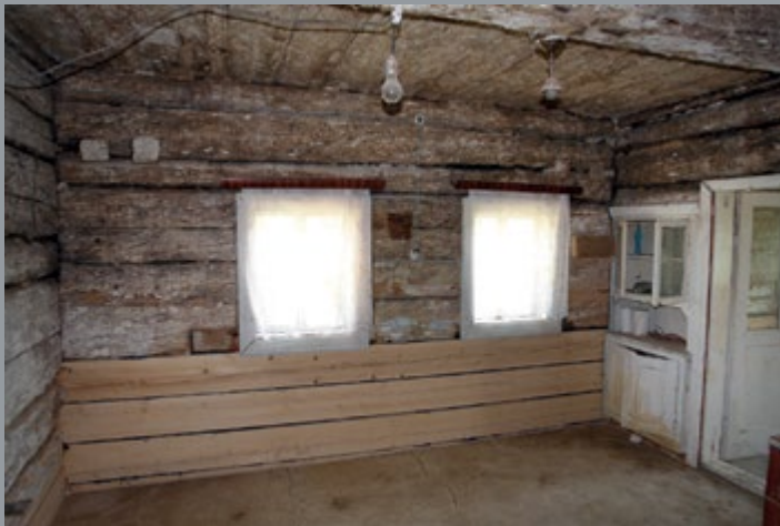
Il. 13. Okna w izbie, ponad którymi – po bokach – relikty belek poleni , fot. T. Łopatkiewicz, maj 2020
